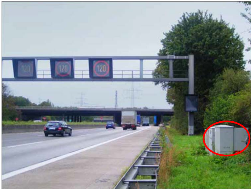
Abbildung 1: Platzierung der IRS an einer Verkehrszeichenbrücke
