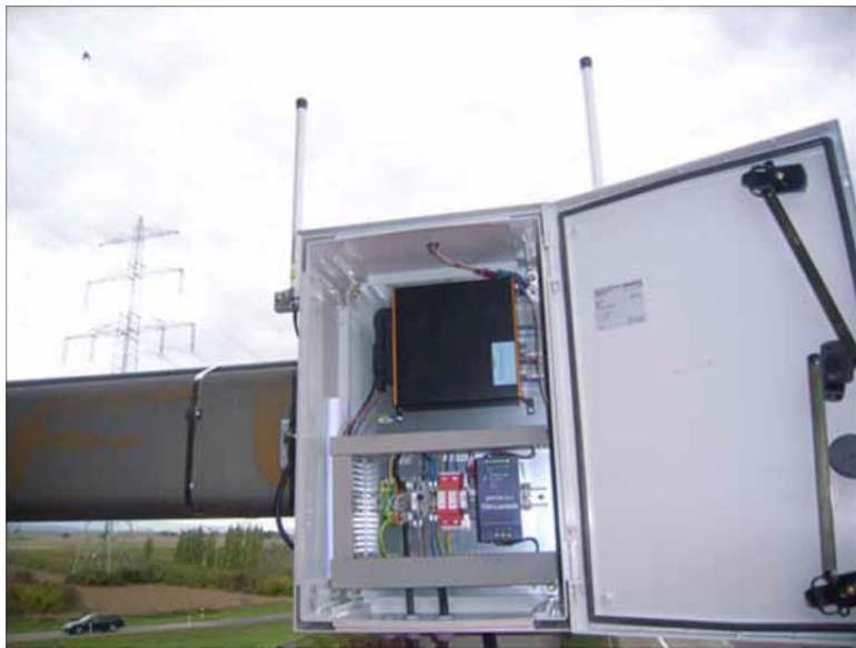
Abbildung 2: Platzierung von CCU und Antennen auf Verkehrszeichenbrücke
